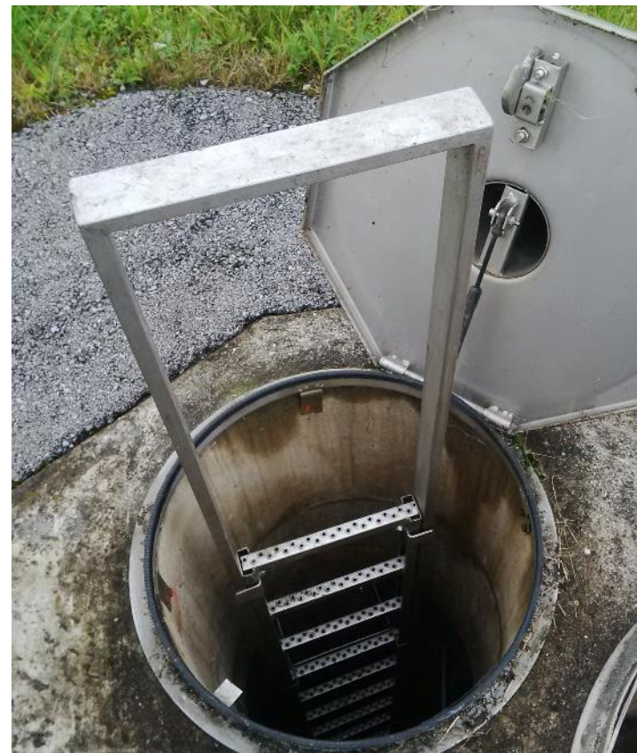
Pumpwerk für Abwässer
